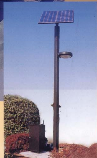
区役所前広場の外灯
